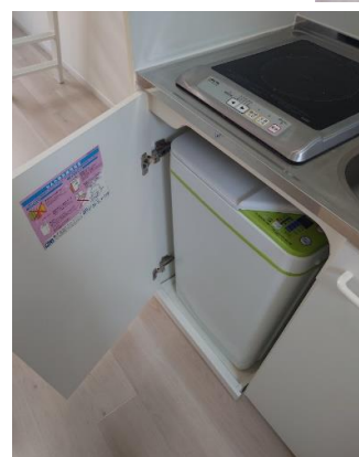
ビルトイン洗濯機&IHコンロ (お部屋により扉の向きが変わります)
